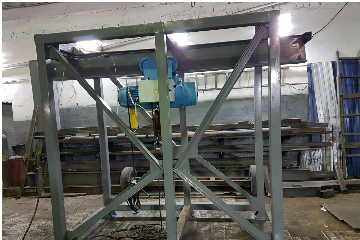
Станция растаривания сыпучих материалов в биг-бэгах СР-2, Подъёмная часть с тельфером. Челябинская обл., п. Увельский, ООО «РАДУГА» («УВЕЛКА»), январь 2017 г.
